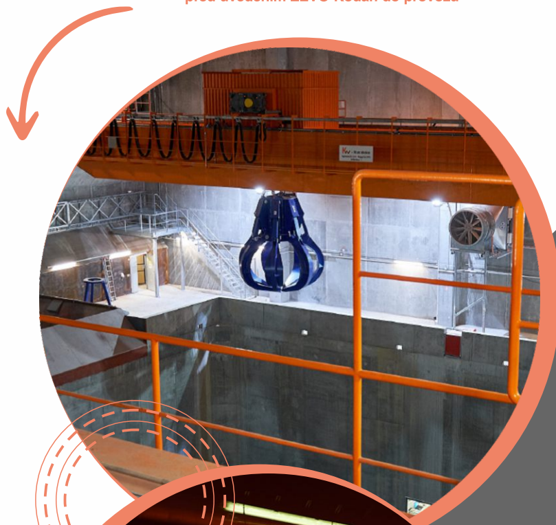
Prázdný bunkr odpadu s drapákem – před uvedením ZEVO Kodaň do provozu
